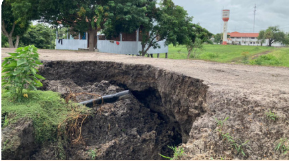
海軍派出所前の道路の路肩が崩落。1月1日
